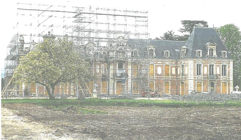
Un gros chantier est en cours pour sauver le château du Petit-Chêne dont une aile a été ravagée par un incendie le 6 mars.
