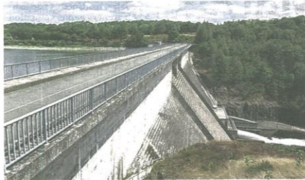
Mis en service en 1995, le barrage de la Touche-Poupard retient 15 millions de m 3 d'eau.
